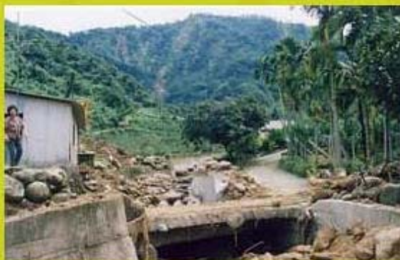
土石流所挾帶的大量土石，容易阻塞橋涵造成土石的滯流。
