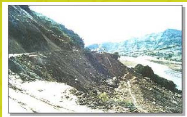
山區道路截斷自然坡面造成崩塌
