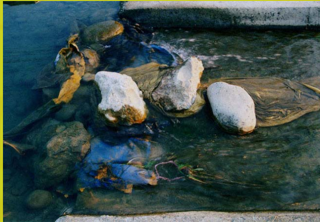
攔砂壩排水缺口，淤積石頭垃圾、塑膠袋等雜物，嚴重影響生態
