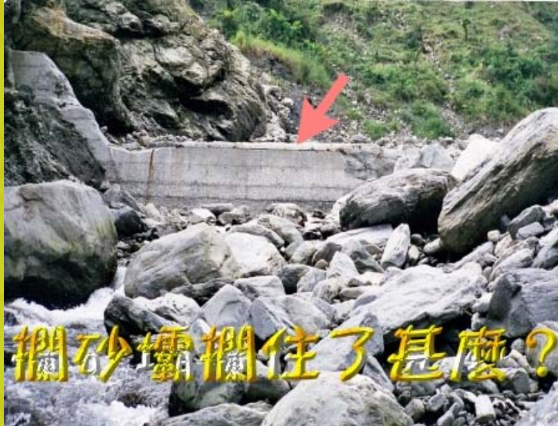
遭土石掩埋的攔砂壩
